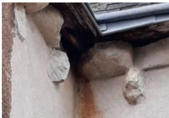
▲ DEP non raccordée à la gouttière
