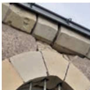
▲ Corniche et claveau de la baie déjointoyés
