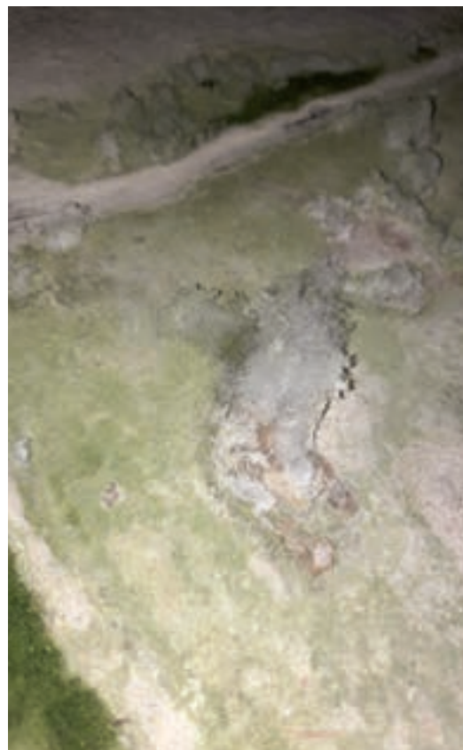
▲ Efflorescences salines sur le sol
