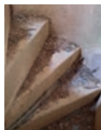
▲ Escaliers et plancher du clocher à nettoyer
