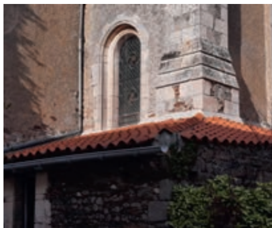
▲ Problème de fissuration d'un solin réalisé en ciment
