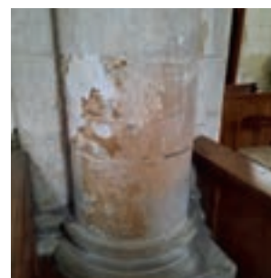
▲ Pulvéulences sur un pilastre
