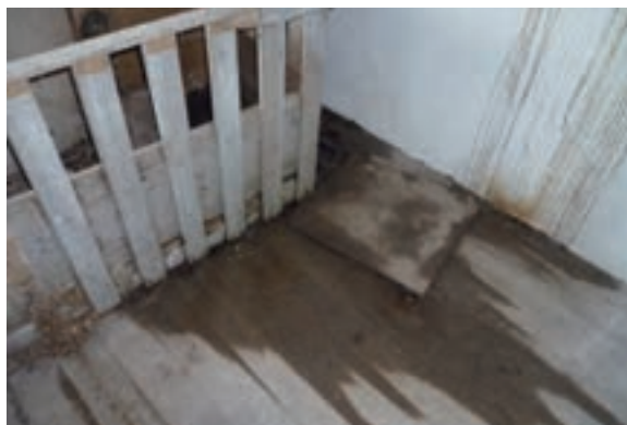
▲ Infiltrations sur le plancher de la tribune
