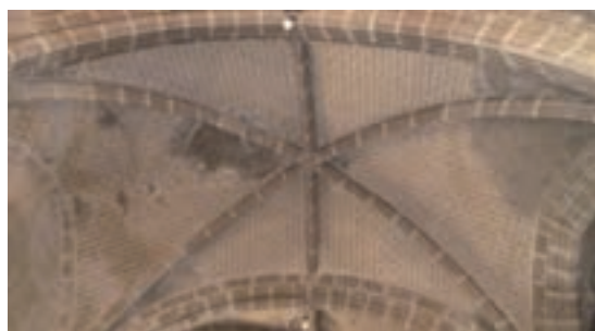
▲ Infiltrations au niveau des voûtes
