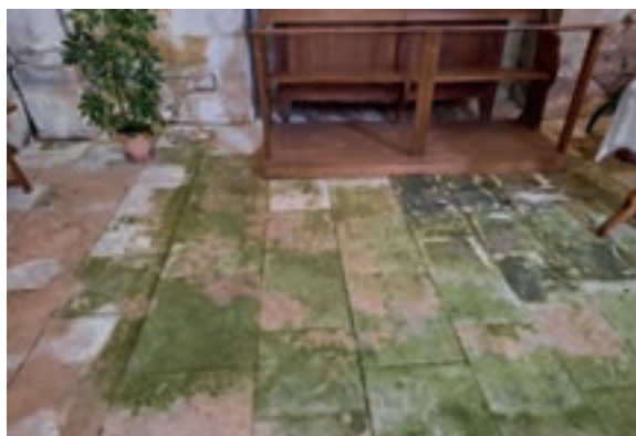
▲ Remontées capillaires par le sol : dalles verdies
