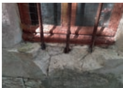
▲ Eclatement de la pierre par oxydation de barreaux
