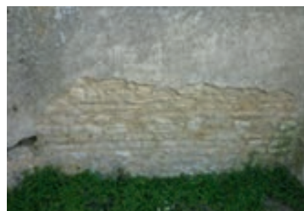
▲ Délitement des enduits en partie basse
