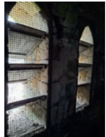
▲ Grilles anti-intrusions devant les abat-sons du clocher
