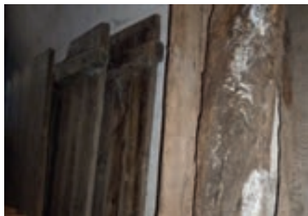
▼ Développement de champignons sur des planches de bois stockées dans un local sous le clocher
