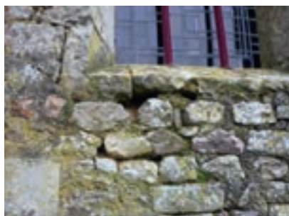
▲ Pierres déchaussées sous une baie
