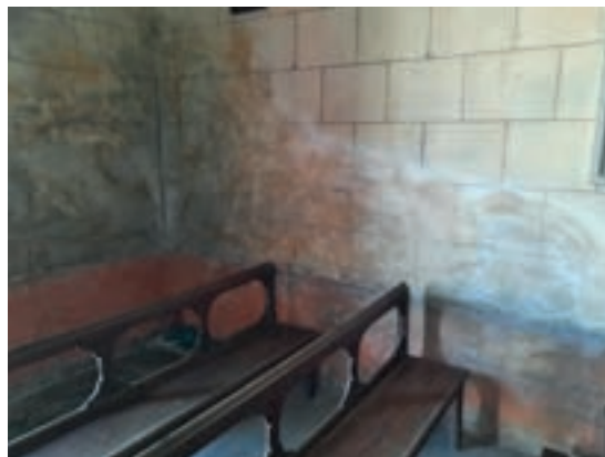
▲ Altération du faux appareillage peint par les remontées capillaires
