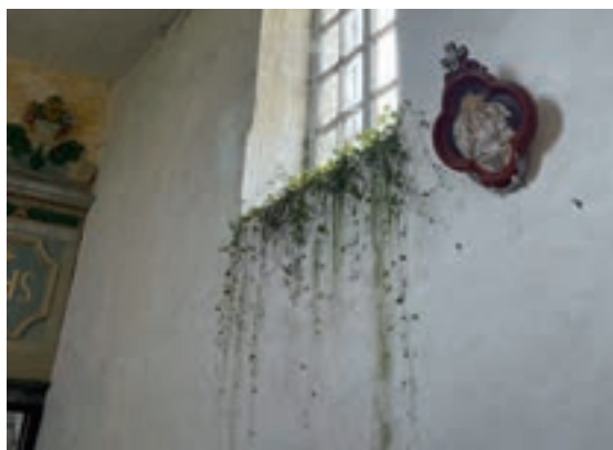
▲ Végétation qui pousse dans l'église sous la menuiserie
