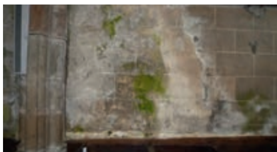
▲ Altération des enduits par les remontées capillaires
