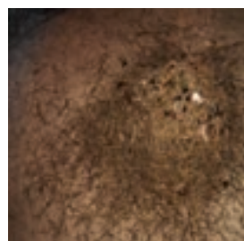
▲ Nids de choucas sur l'extrados des voûtes et la passerelle
