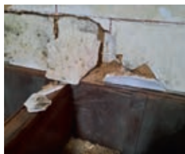
▲ Délitement des enduits par plaques
